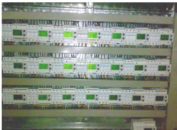
Img. 1 | Sistema de análise de consumos de energia montado na Central de Trigeração da Climaespaço no Parque das Nações em Lisboa (instalado em 2009).
