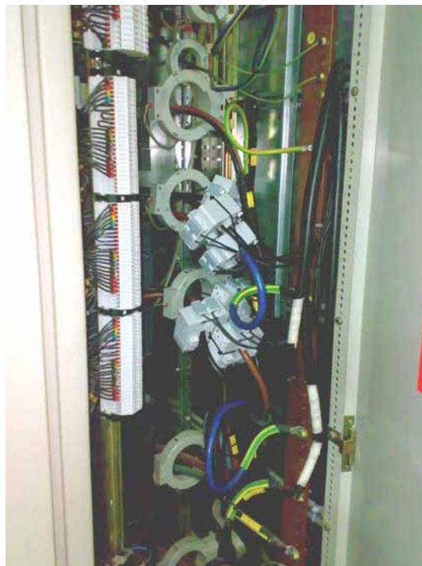
Img. 2 | TIs montados em quadro Climaespaço Central de Trigeração (instalado em 2009).
